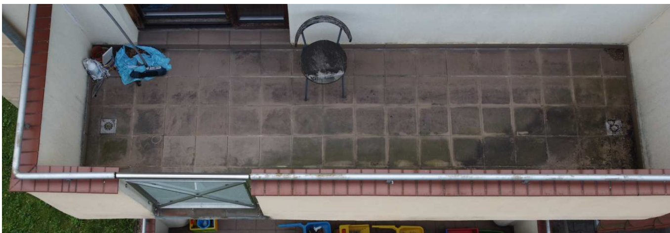
Fot. 3.2. Przykładowy balkon pierwszej kondygnacji – typ 2 (długi)
