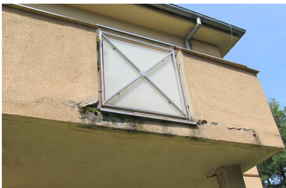
Fot. 12. Dochodzi do przenikania wody opadowej pod posadzkę i do wykwitów wilgoci na otwartych krawędziach oraz na spodach płyt balkonowych
