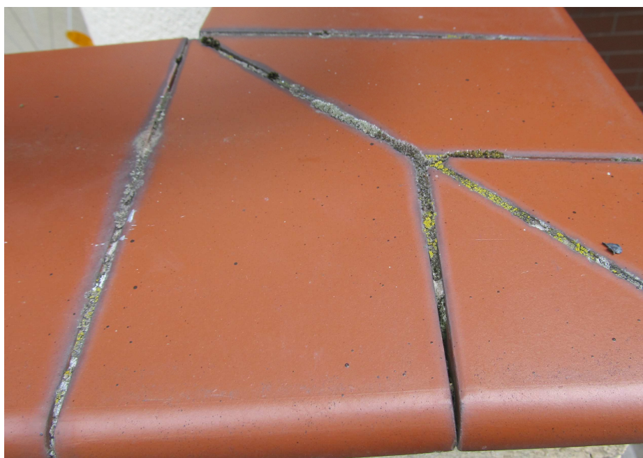
Fot. 11. Na niezadaszonych balkonach pierwszej kondygnacji stwierdzono ubytki fug na posadzce oraz na płytkach wieńczących murowane balustrady
