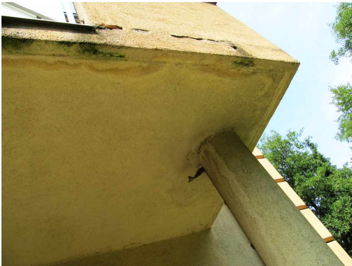
Fot. 13. Dochodzi do przenikania wody opadowej pod posadzkę i do wykwitów wilgoci na otwartych krawędziach oraz na spodach płyt balkonowych
