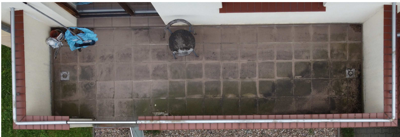
Fot. 10. Na niezadaszonych balkonach pierwszej kondygnacji stwierdzono lokalne uszkodzenia wpustów odpływowych oraz ubytki fug na posadzce oraz na płytkach wieńczących murowane balustrady
