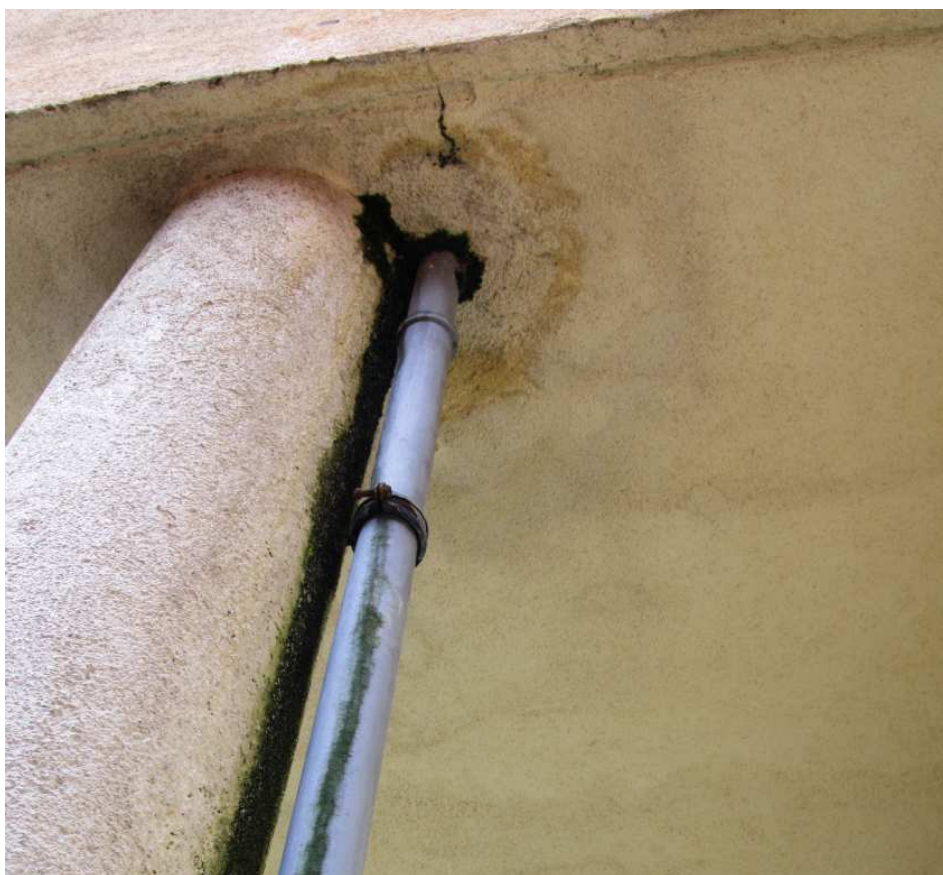
Fot. 14. Dochodzi do przenikania wody opadowej pod posadzkę i do wykwitów wilgoci na otwartych krawędziach oraz na spodach płyt balkonowych
