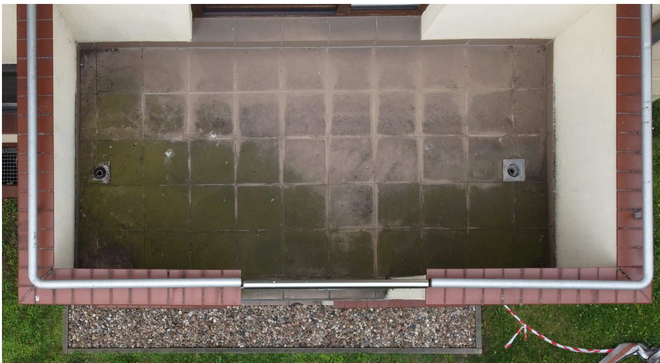
Fot. 9. Na niezadaszonych balkonach pierwszej kondygnacji stwierdzono lokalne uszkodzenia wpustów odpływowych oraz ubytki fug na posadzce oraz na płytkach wieńczących murowane balustrady
