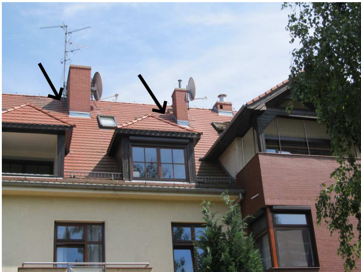
Fot. 7. Przy dwóch kominach zlokalizowanych na zachodniej połaci dachu, stwierdzono lokalne wysunięcia i przemieszczenia dachówek oraz ubytek jednej dachówki
