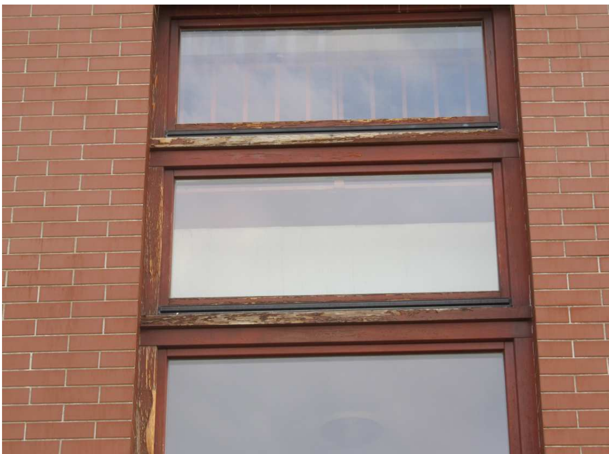
Fot. 28. Zaobserwowano znaczne złuszczenia powłoki malarskiej na stolarce okiennej klatek schodowych jak i na stolarce wykonanej w drewnianych lukarnach
