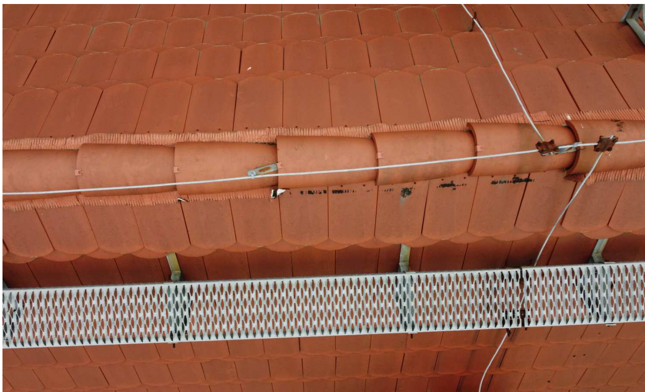
Fot. 21. Stwierdzono nieprawidłowości w zakresie kalenicy budynku, gdzie w kilku obszarach dochodzi do wysuwania się dachówek spod gąsiorów dachowych oraz do uszkodzeń taśmy kalenicowej. Zjawisko to zaobserwowano wzdłuż głównej kalenicy dachu
