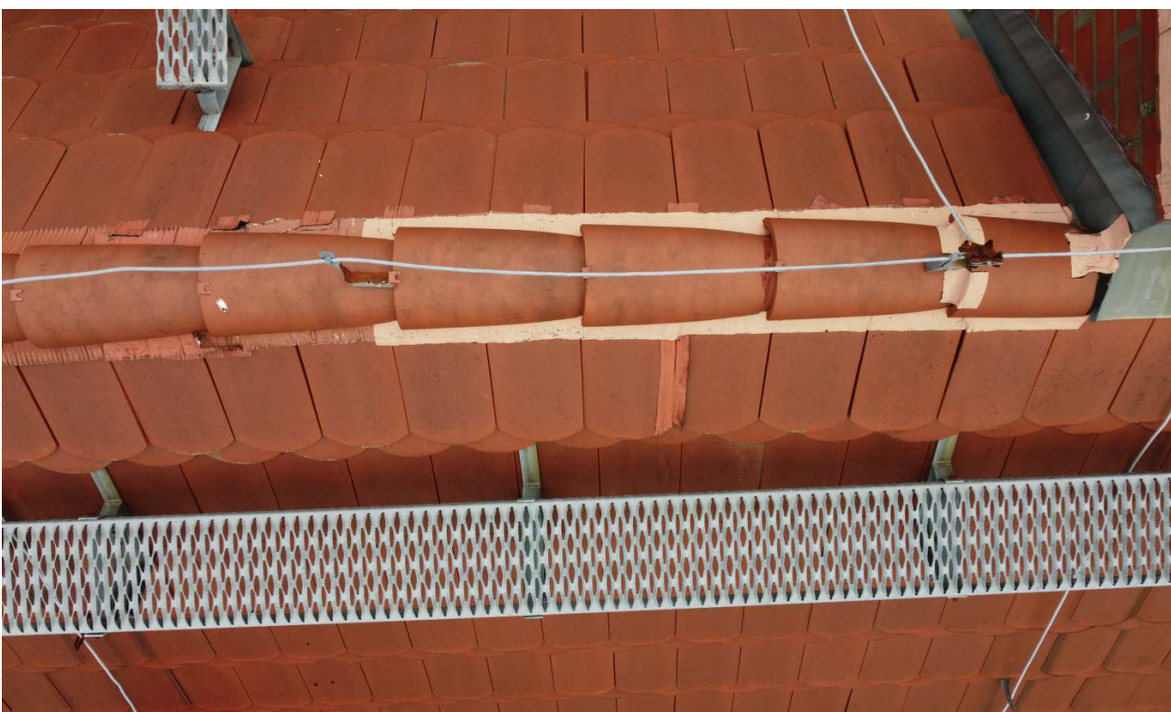
Fot. 22. Stwierdzono nieprawidłowości w zakresie kalenicy budynku, gdzie w kilku obszarach dochodzi do wysuwania się dachówek spod gąsiorów dachowych oraz do uszkodzeń taśmy kalenicowej. Zjawisko to zaobserwowano wzdłuż głównej kalenicy dachu
