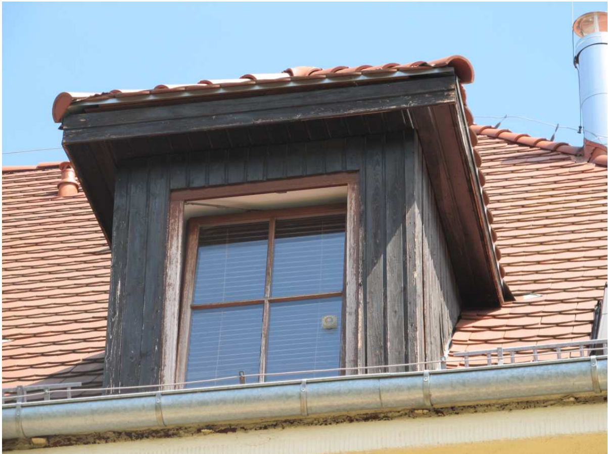
Fot. 19. Zaobserwowano znaczne złuszczenia powłoki malarskiej na stolarce okiennej klatek schodowych jak i na stolarce wykonanej w drewnianych lukarnach
