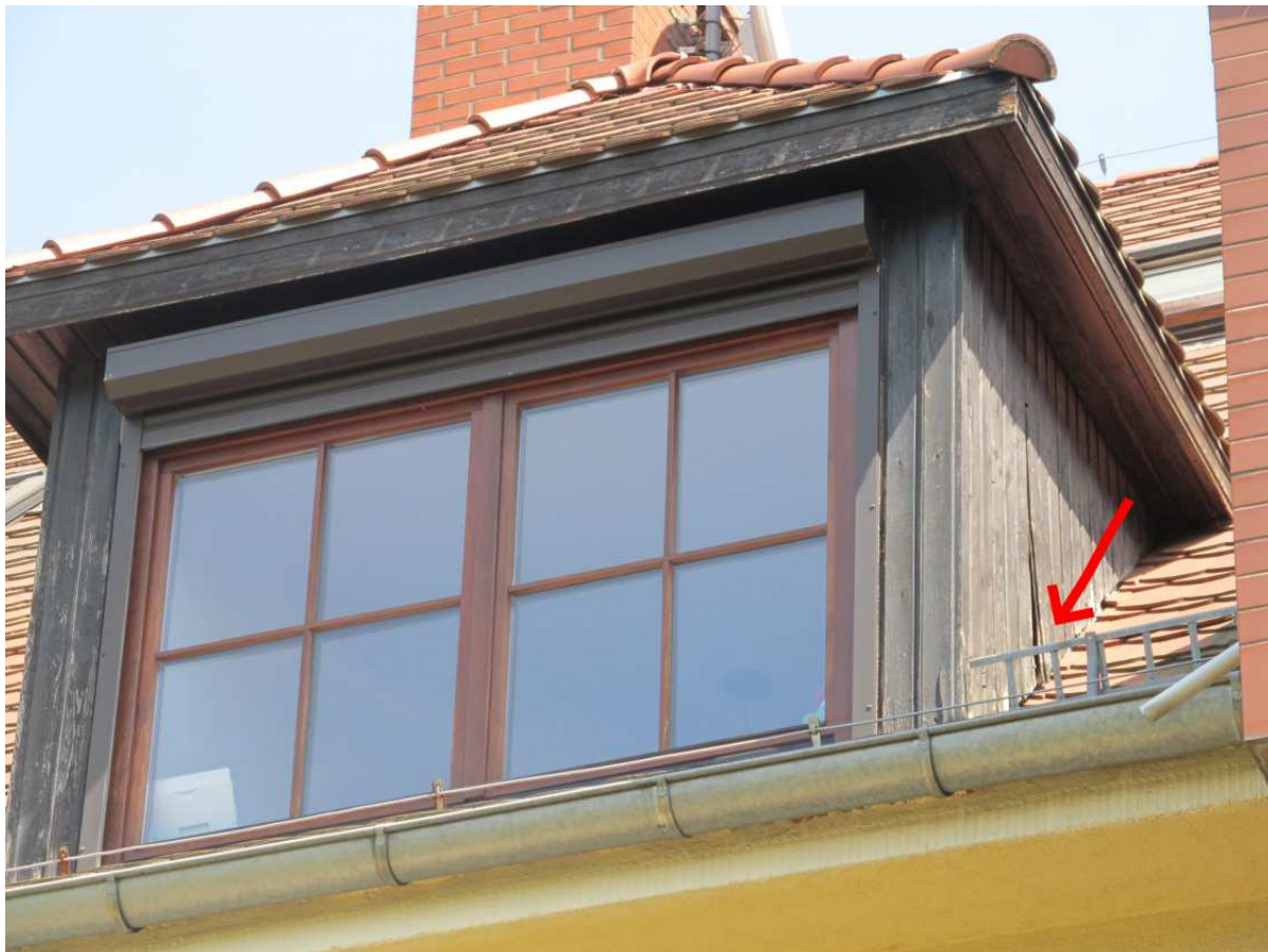
Fot. 17. W kilkunastu miejscach stwierdzono lokalne zwichrzenia desek oraz uszkodzenia w miejscu ich mocowania
