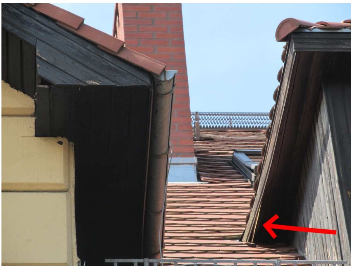
Fot. 16. W kilkunastu miejscach stwierdzono lokalne zwichrzenia desek oraz uszkodzenia w miejscu ich mocowania
