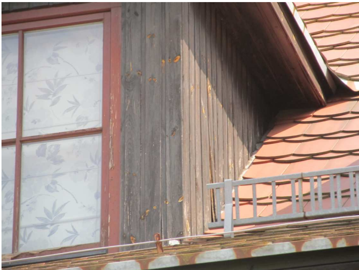
Fot. 25. W kilku miejscach stwierdzono lokalne zwichrzenia desek oraz uszkodzenia w miejscu ich mocowania
