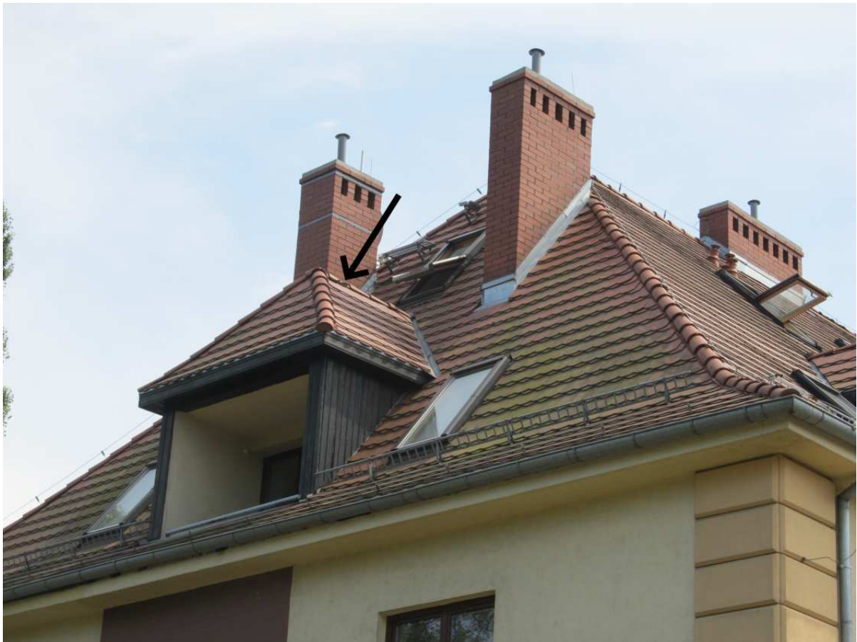
Fot. 5. Fragment kalenicy na zadaszeniu lukarny zlokalizowanej na północnej połaci szczytowej, gdzie stwierdzono lokalne odkształcenie taśmy
