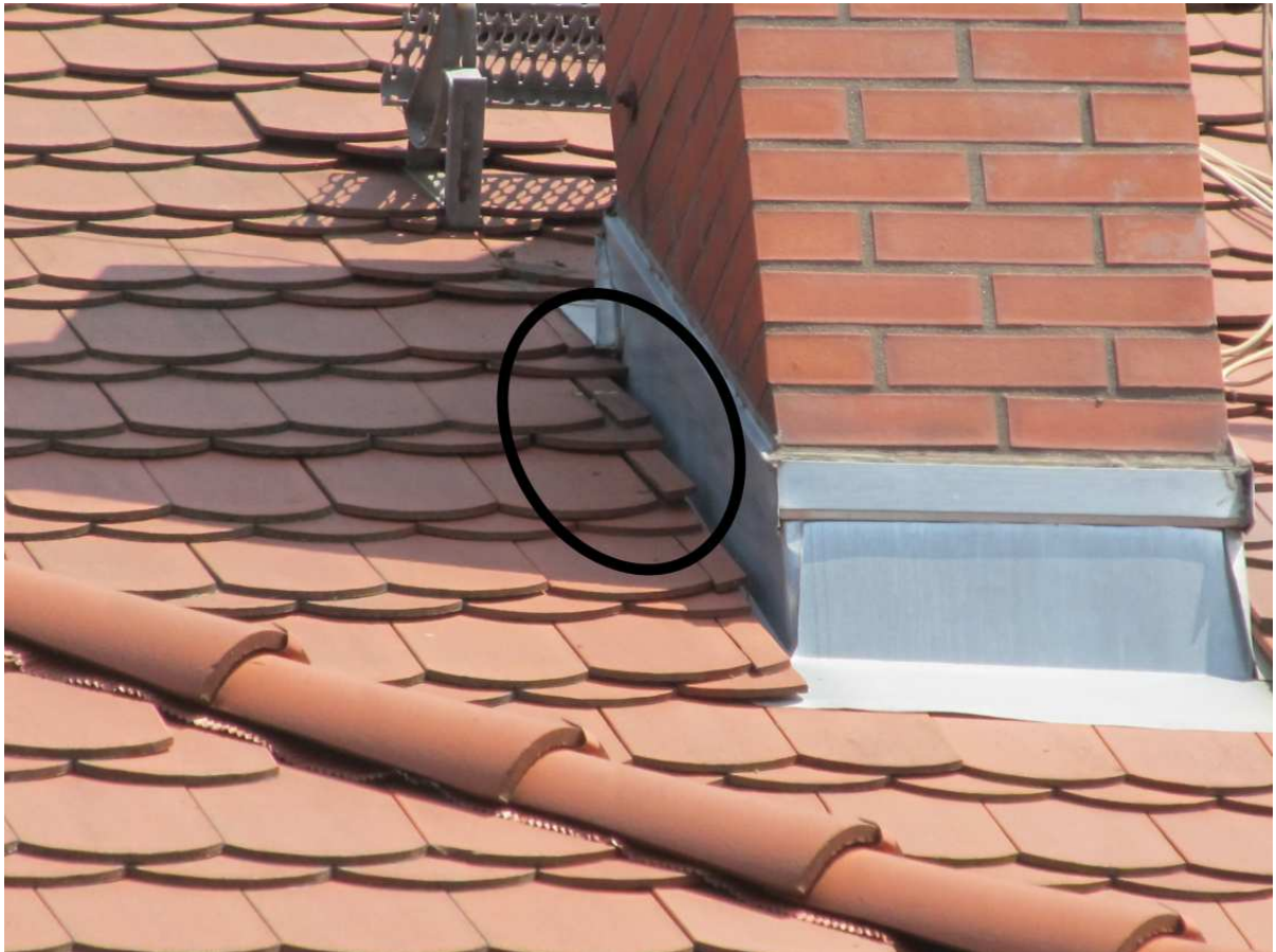
Fot. 9. Przy dwóch kominach zlokalizowanych na zachodniej połaci dachu, stwierdzono lokalne wysunięcia i przemieszczenia dachówek oraz ubytek jednej dachówki
