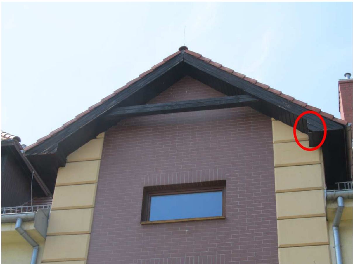
Fot. 10. Stwierdzono lokalne ubytki fragmentów deskowania na zadaszeniu nad klatką 34 – na połaci wschodniej
