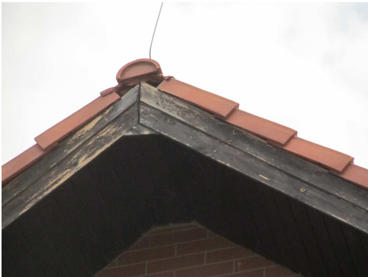
Fot. 27. Na wielu obszarach deskowania doszło już do złuszczeń powłoki malarskiej zabezpieczającej drewno przed niekorzystnymi warunkami atmosferycznymi
