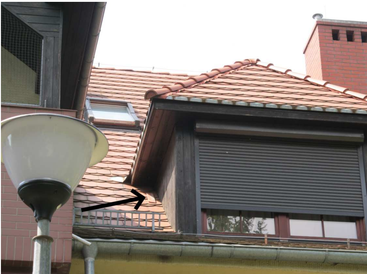
Fot. 24. Przy jednej z lukarn zlokalizowanej na wschodniej połaci dachu, stwierdzono lokalne wysunięcie i przemieszczenie jednej dachówki
