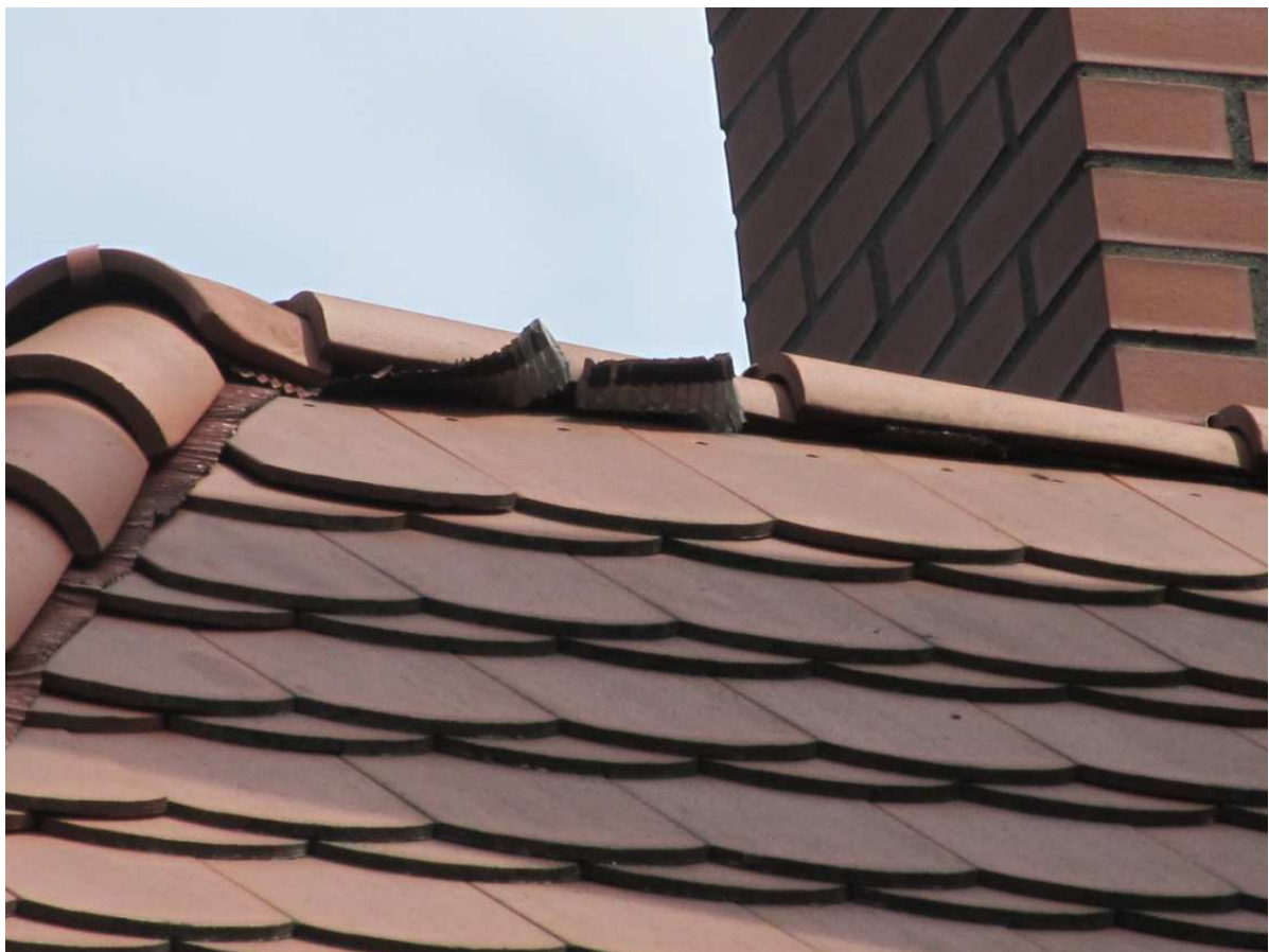
Fot. 6. Fragment kalenicy na zadaszeniu lukarny zlokalizowanej na północnej połaci szczytowej, gdzie stwierdzono lokalne odkształcenie taśmy
