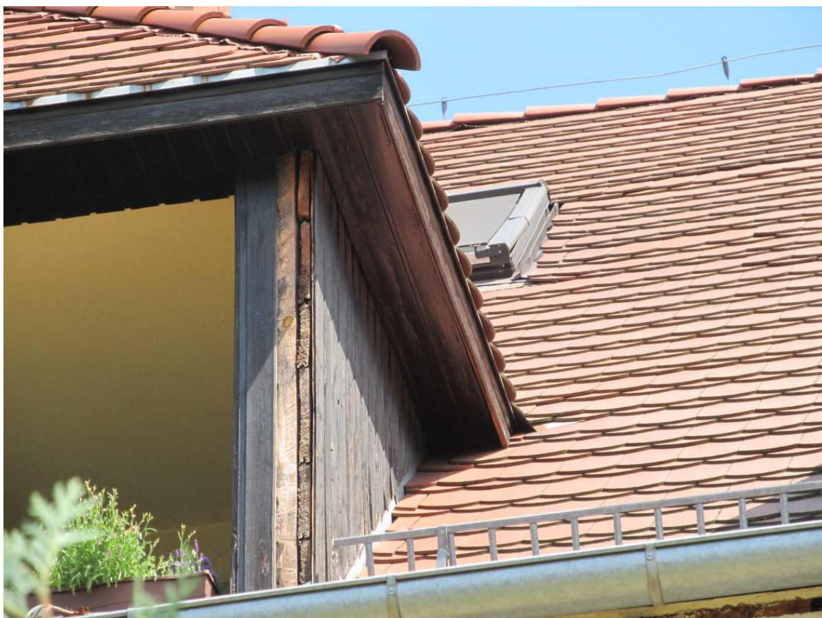
Fot. 14. Stwierdzono lokalne ubytki fragmentów deskowania na lukarnie (bez okna) zlokalizowanej na połaci zachodniej pomiędzy klatką 32 i 34
