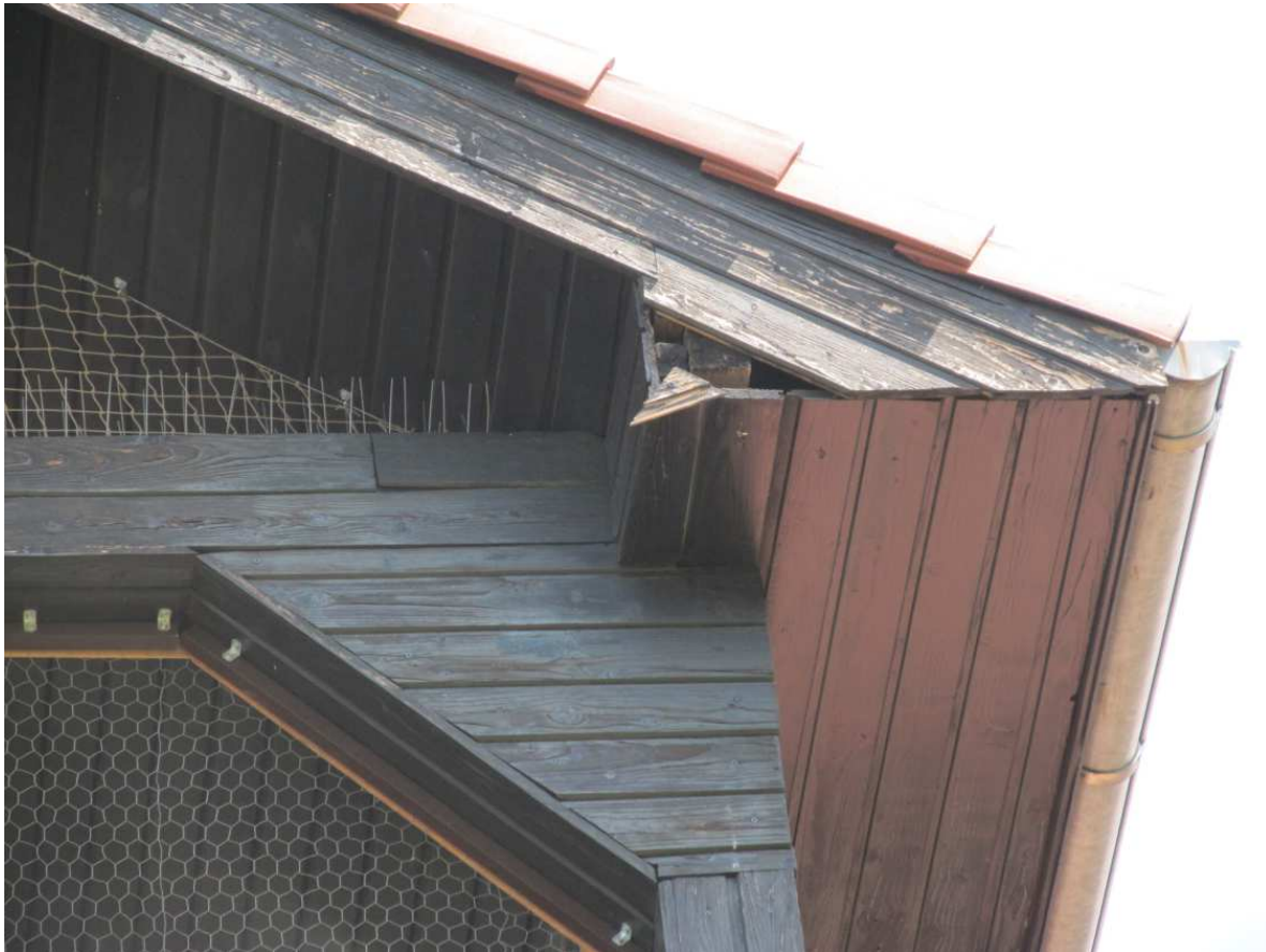
Fot. 13. Stwierdzono lokalne ubytki fragmentów deskowania na zadaszeniu tarasu na zwieńczeniu klatki 34 – na połaci zachodniej
