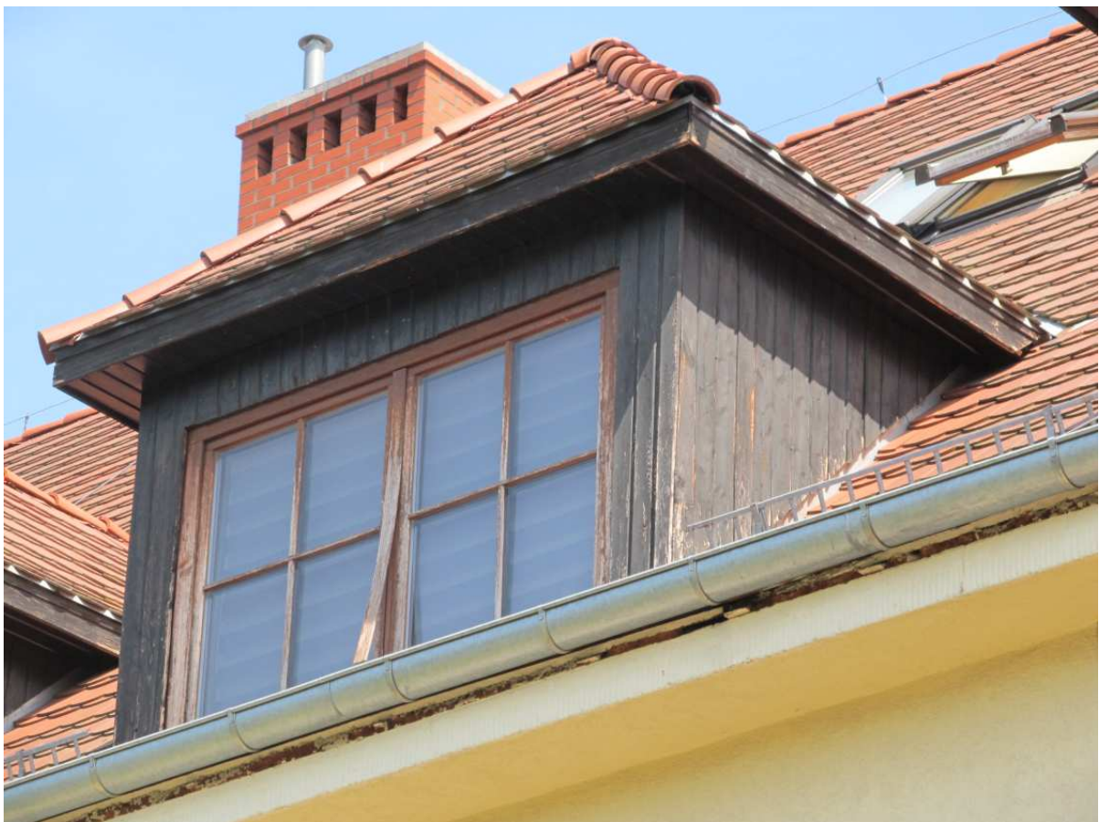
Fot. 20. Na jednym oknie zamontowanym w lukarnie na połaci zachodniej doszło do częściowego odspojenia szprusu
