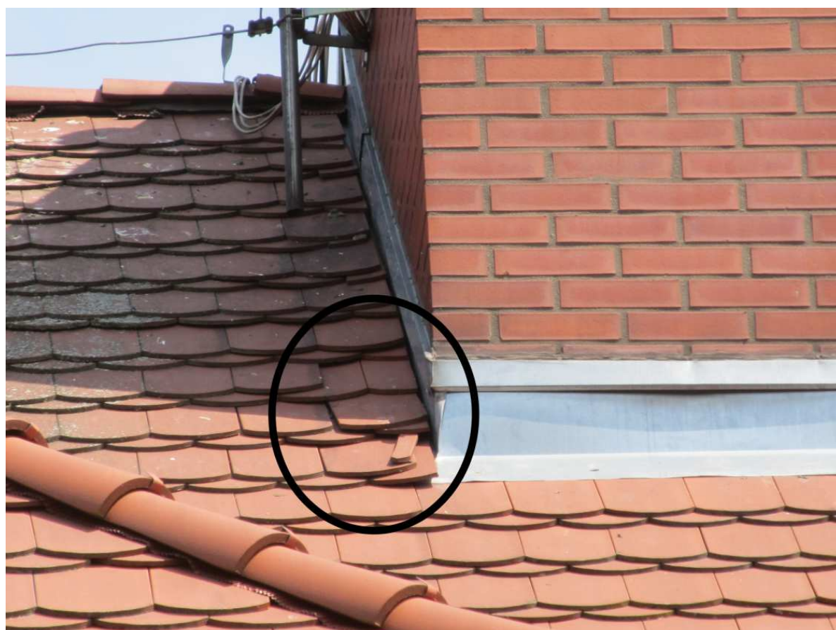
Fot. 8. Przy dwóch kominach zlokalizowanych na zachodniej połaci dachu, stwierdzono lokalne wysunięcia i przemieszczenia dachówek oraz ubytek jednej dachówki
