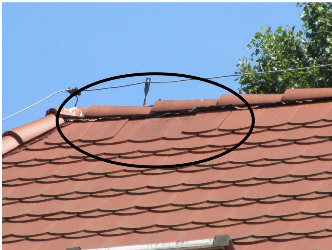
Fot. 1. Stwierdzono nieprawidłowości w zakresie kalenicy budynku, gdzie w kilku obszarach dochodzi do wysuwania się dachówek spod gąsiorów dachowych oraz do uszkodzeń taśmy kalenicowej. Zjawisko to zaobserwowano wzdłuż głównej kalenicy dachu
