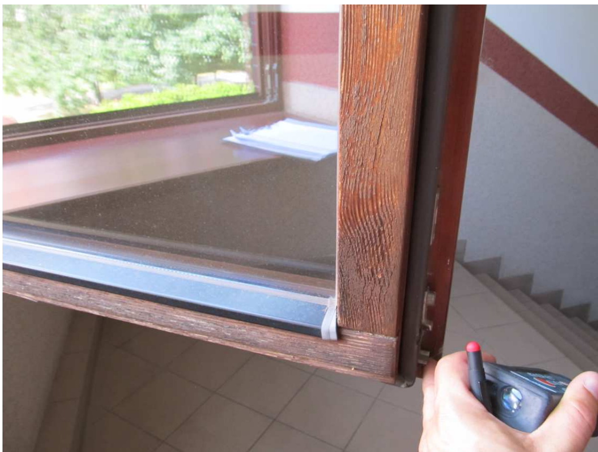
Fot. 18. Zaobserwowano znaczne złuszczenia powłoki malarskiej na stolarce okiennej klatek schodowych jak i na stolarce wykonanej w drewnianych lukarnach
