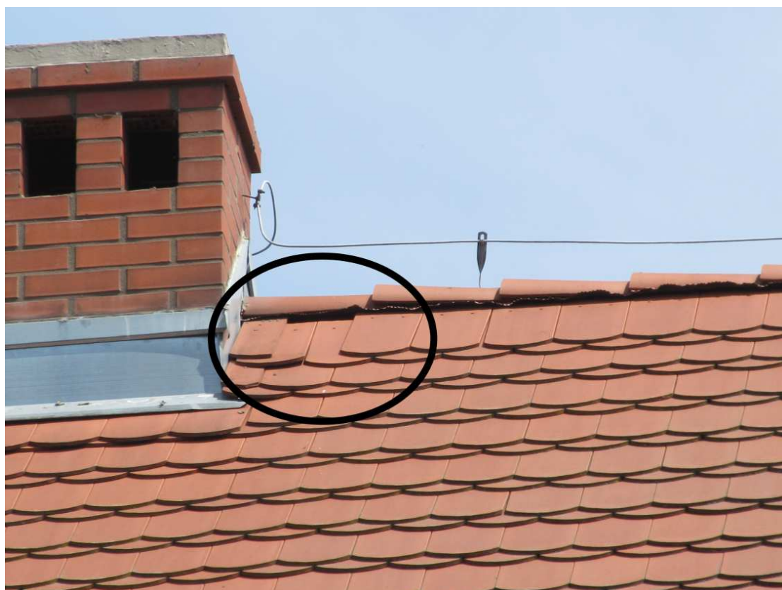
Fot. 2. Stwierdzono nieprawidłowości w zakresie kalenicy budynku, gdzie w kilku obszarach dochodzi do wysuwania się dachówek spod gąsiorów dachowych oraz do uszkodzeń taśmy kalenicowej. Zjawisko to zaobserwowano wzdłuż głównej kalenicy dachu
