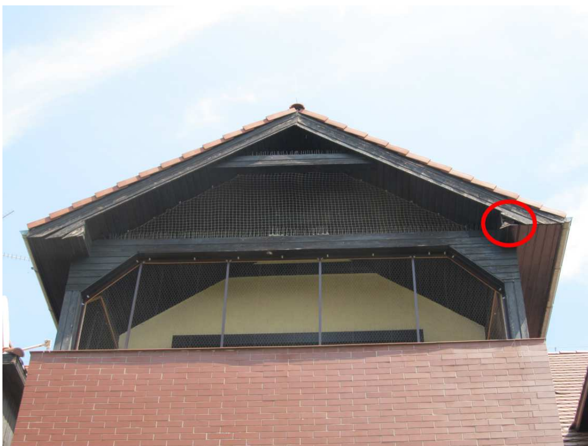
Fot. 12. Stwierdzono lokalne ubytki fragmentów deskowania na zadaszeniu tarasu na zwieńczeniu klatki 34 – na połaci zachodniej
