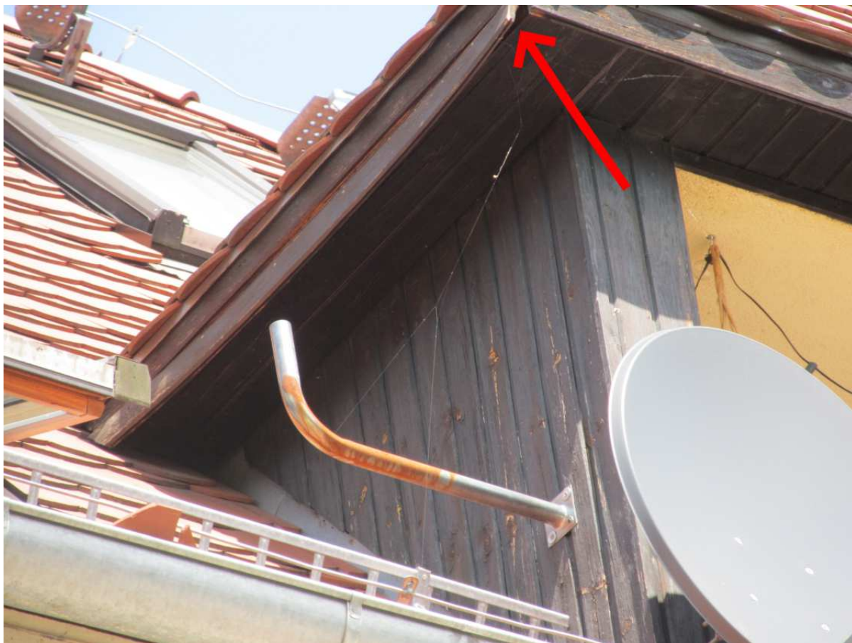
Fot. 15. W kilkunastu miejscach stwierdzono lokalne zwichrzenia desek oraz uszkodzenia w miejscu ich mocowania
