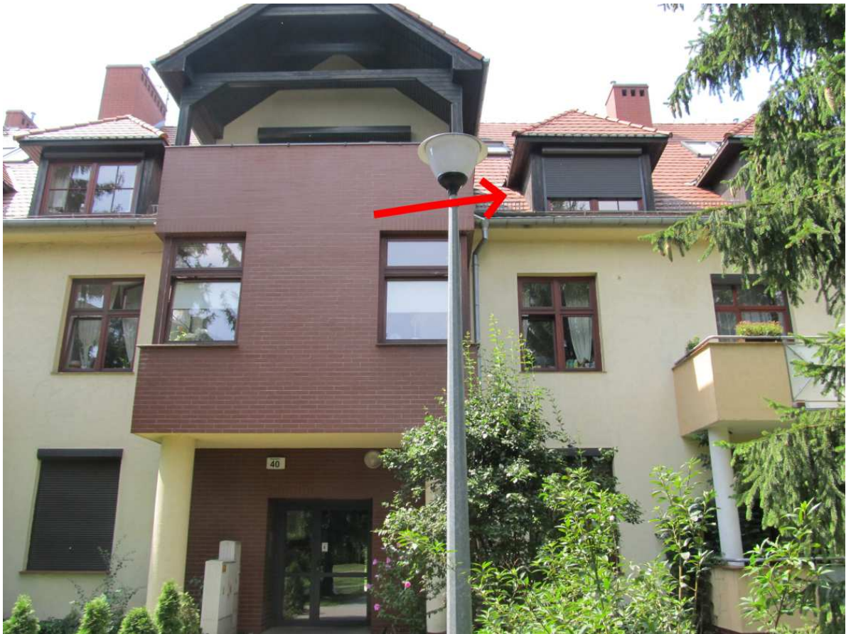
Fot. 23. Przy jednej z lukarn zlokalizowanej na wschodniej połaci dachu, stwierdzono lokalne wysunięcie i przemieszczenie jednej dachówki
