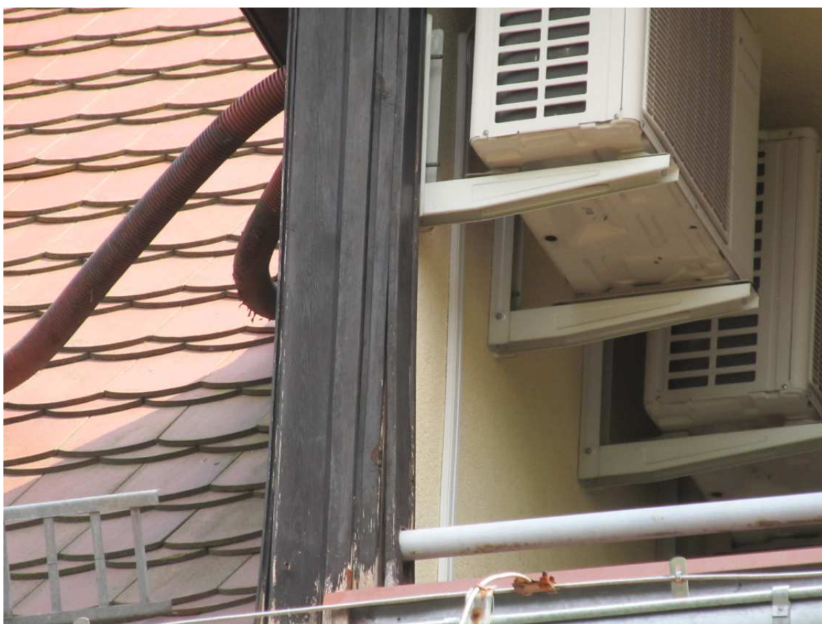
Fot. 26. W kilku miejscach stwierdzono lokalne zwichrzenia desek oraz uszkodzenia w miejscu ich mocowania
